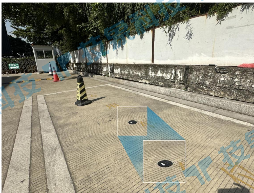
图 40 地磁传感器在路面停车场的应用
